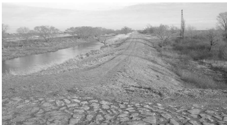
Figura 21 Aspectul coroanei digului de-a lungul Canalului Bega
